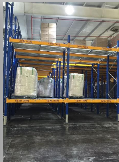
Mantenimiento rack tipo flow-rack
